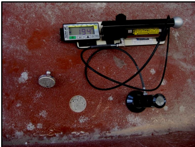
Extracción de este dolly acusa zona de hormigón superficial pobre en resistencia.
